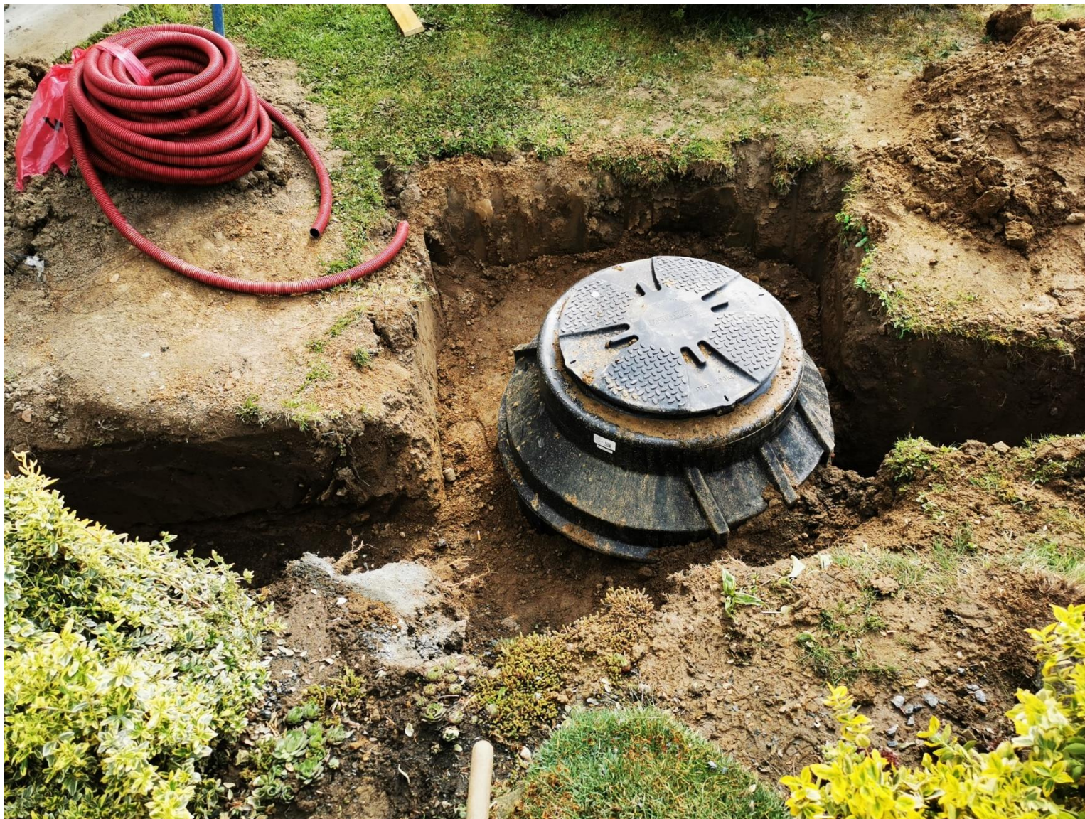
DOMOVNÍ ČERPACÍ JÍMKA
