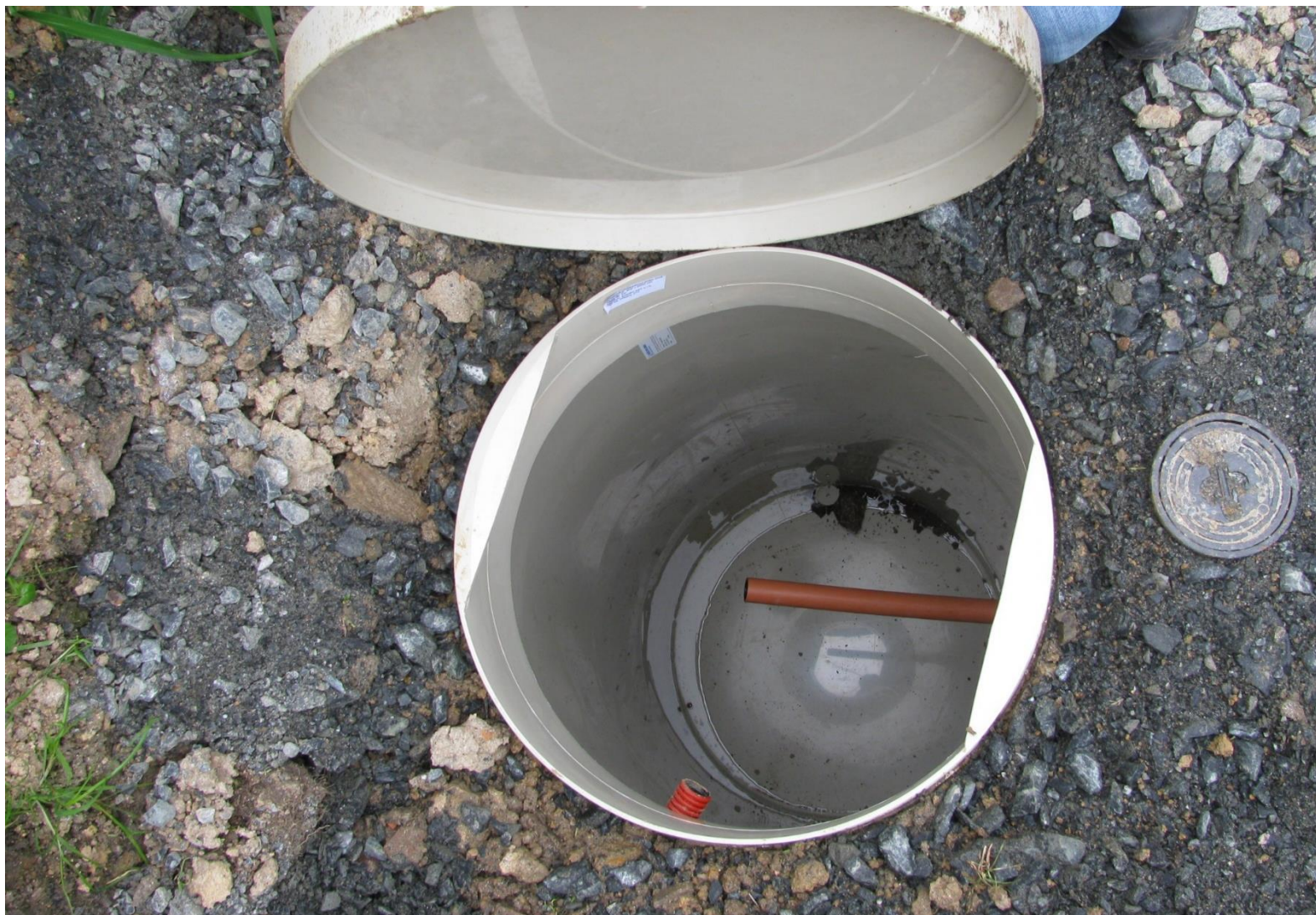
DOMOVNÍ ČERPACÍ JÍMKA S TLAKOVÝM POTRUBÍM
